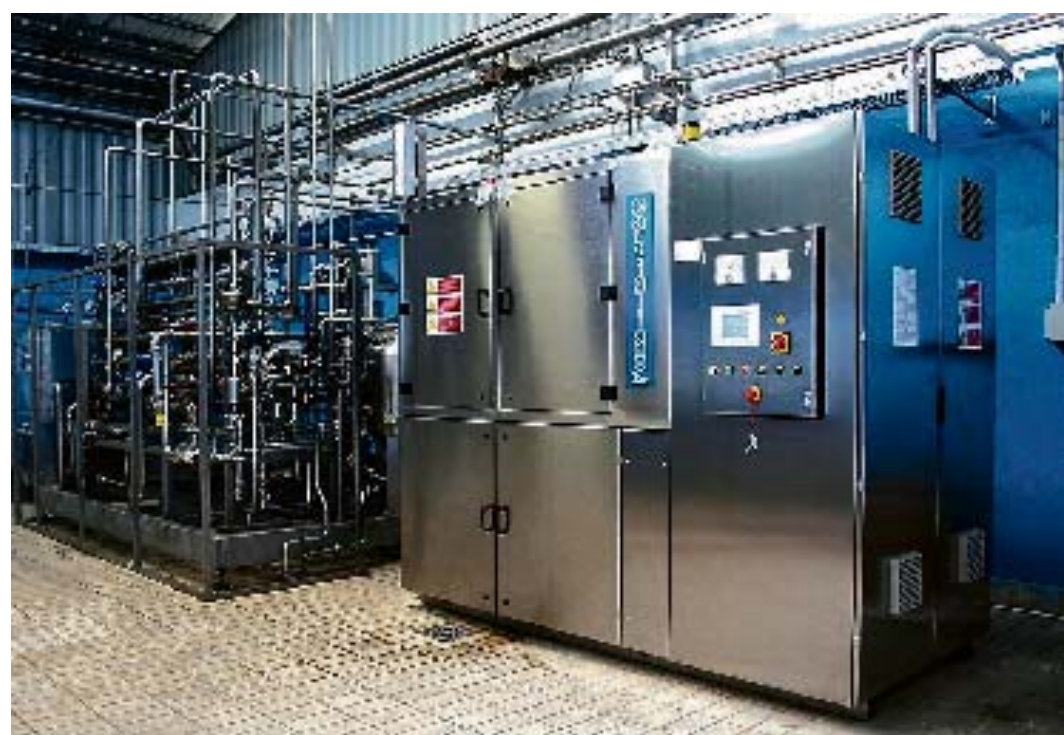
L'impianto di sterilizzazione alimentare
